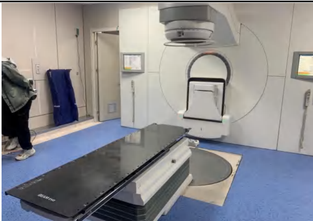
直加机房内设备情况
