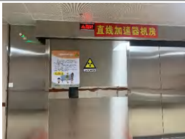
防护门（指示灯、警示标志）
