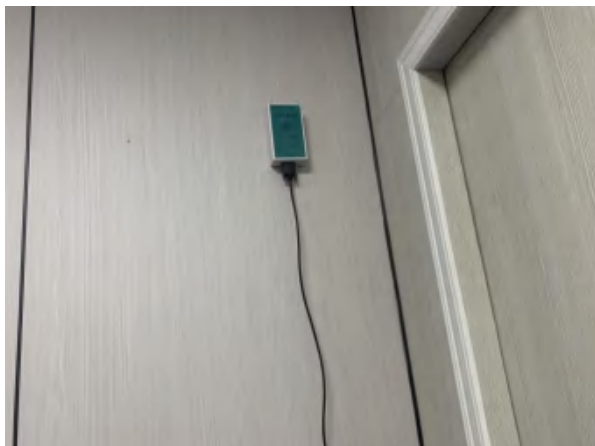
固定式剂量报警仪（机房内）
